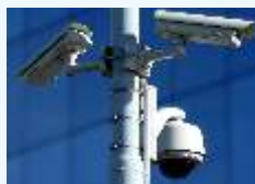
Sistemas de CCTV
